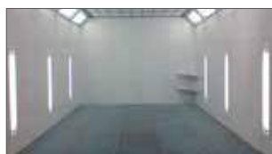
Δάπεδο με όλο σχάρα και φωτισμό στα πάνελ σε κάθετη διάταξη με LED φωτιστικά απόδοσης 6.500 lumen
